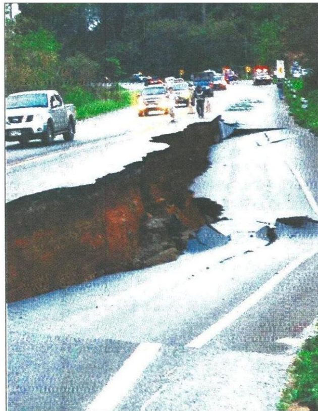
▲ ถนนพังถล่ม : ถนนพหลโยธิน ช่วง ต.เมืองพาน อ.พาน จ.เชียงราย ทรุดตัวและแตกร้าวจากแรงแผ่นดินไหว ระหว่าง ที่ประชาชนขับรถยนต์สัญจรผ่านแบบสดๆ เห็นกับตา ในเวลาประมาณ 18.00 น. วันที่ 5 พฤษภาคม 2557
