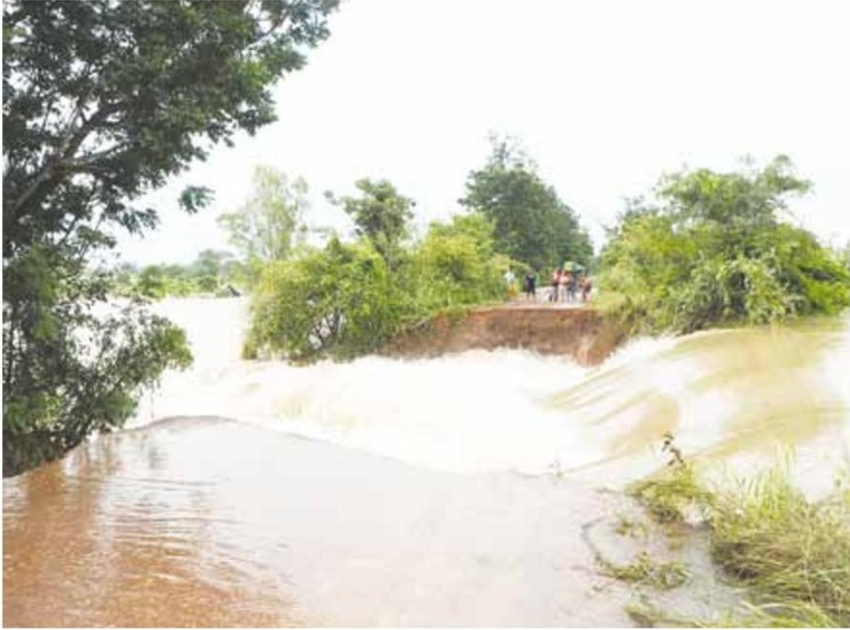
▲ ถนนขาด...ถนนชลประทาน บริเวณหมู่ 3 อ.กบินทร์บุรี จ.ปราจีนบุรี ซึ่งเป็นถนนที่กั้นแควน้ำปราจีนบุรี ได้ถูกน้ำเซาะขาดกว้างประมาณ 40 เมตร น้ำได้พุ่งทะลักออกอย่างรุนแรง เข้าทุ่ง ต.วังตาล อ.กบินทร์บุรี ชาวหลายหมื่นไร่จมน้ำ
